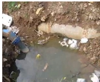
Tubería de agua potable cubierta de aguas albañales
