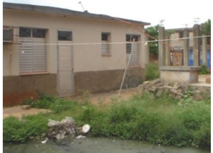
Fosa reventada aledaña a la cisterna
