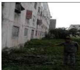
Señalando aguas albañales
