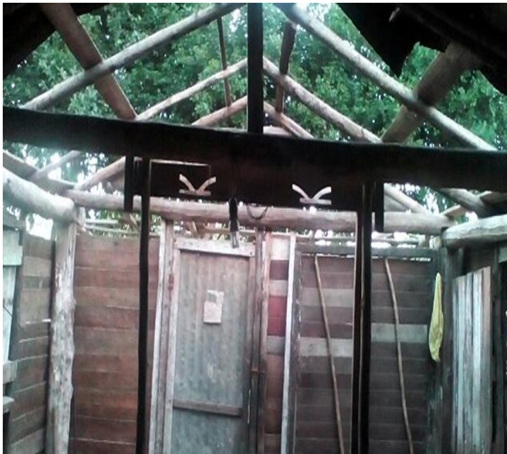
Casa de vivienda afectada.
