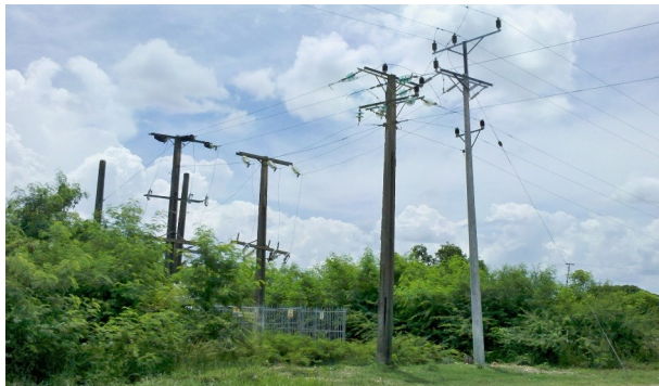
Subestación donde debe conectarse el cable neutro
