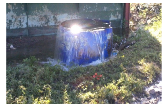
Salidero de agua
