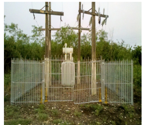
Subestación N°44 El Cieguito.
