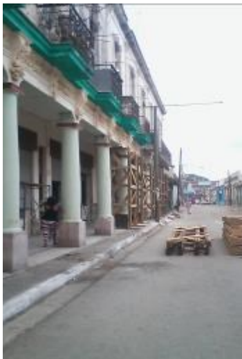
Inmueble apuntalado. Foto el autor
